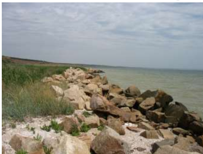
Рис. 1. Приклад невдалого захисту піщаного берегу Бердянської коси скельними кам'яними накладами (Азовське море). Можна бачити дію накатних потоків морської води під час штормів і занурення в пісок уламків скельної породи
